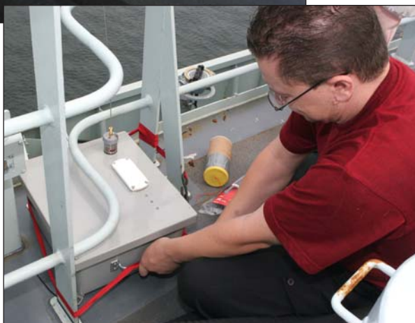
Installation d'une station AVMS éloignée à bord du NCSM Goose Bay
